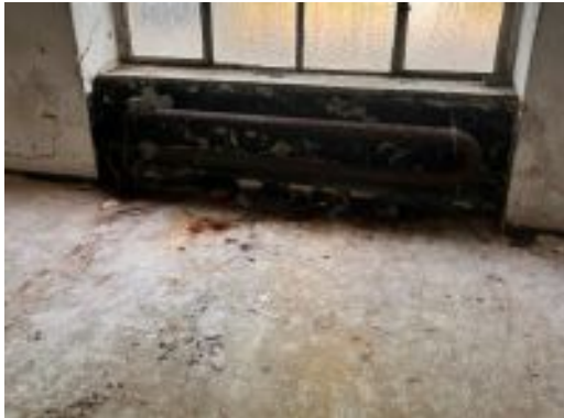
Abgängiger Rippenrohr radiator
