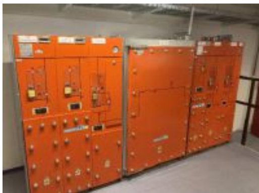
Mittelspannungsschaltanlage – MSHV / B 0.007
