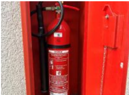
Co 2 - Feuerlöscher – Trafostation / EG
