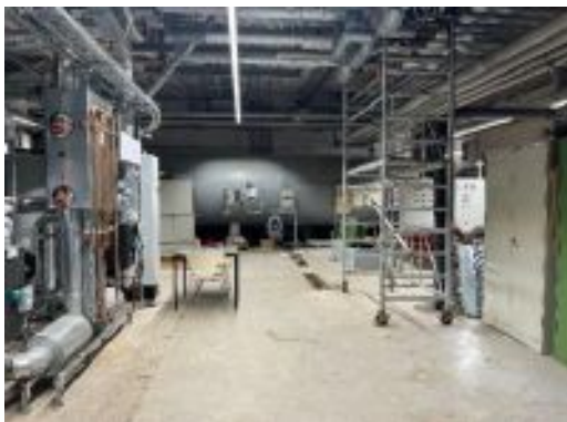
Heizungs-, Sanitär- und Sprinklerzentrale
