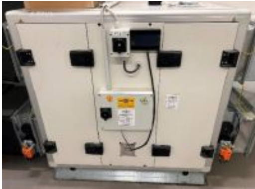
Lüftung Komaktgerät Umkl./UG
