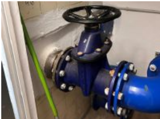
TWK Hauptabspernung DN150 – Villa/UG
