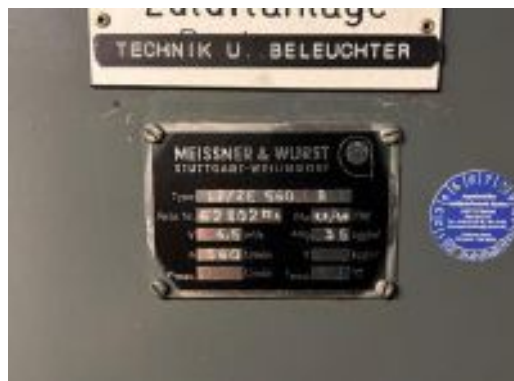
Älteste RLT – RLT-Zentrale/UG
