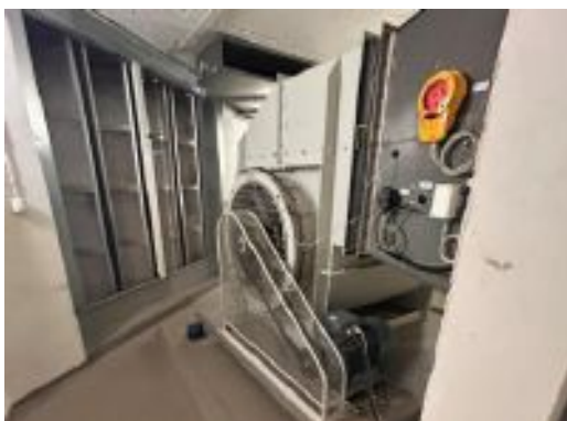
Zuluftgerät Saal– RLT-Zentrale/UG
