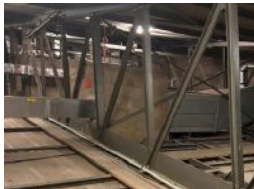
Abluftgerät Saal – Dachraum/DG
