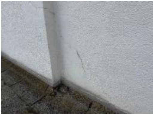
Zahlreiche Rissbildungen Fassade – SSH
