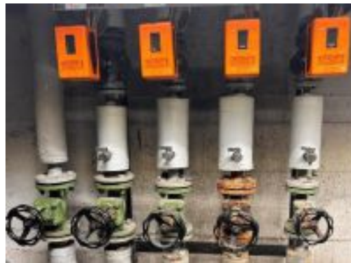
Neue Feldgeräte – RLT-Zentrale/UG
