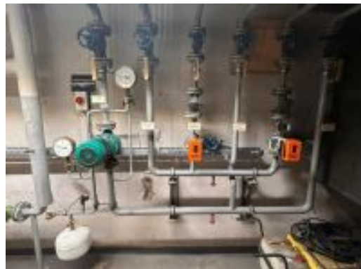
Hydraulik WRG – RLT-Zentrale/UG
