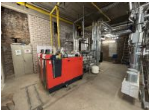
Heizzentrale Gebäude 11 OG
