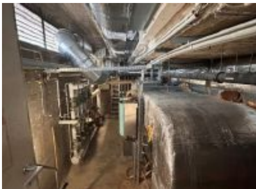
RLT – Klimazentrale Ballett u. Chor/UG
