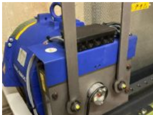
Aufzugsmaschine Baujahr 2025 – EG
