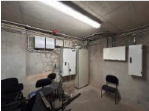
Verteiler und SiBel BS – Nebengebäude/KG
