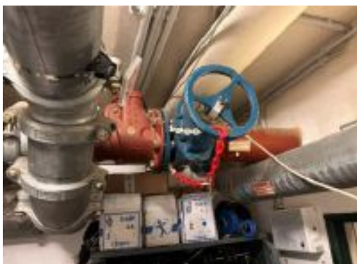
Absperrung Pumpendruckleitung / UG
