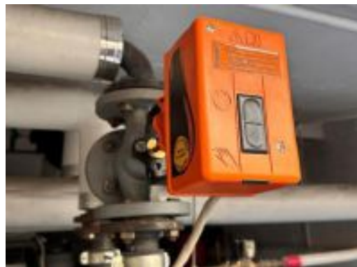
Feldgeräte – Lüftungszentrale /DG
