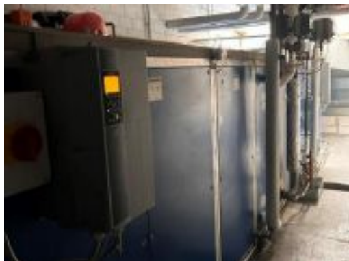
Lüftung Veranstaltung – Zentrale/DG
