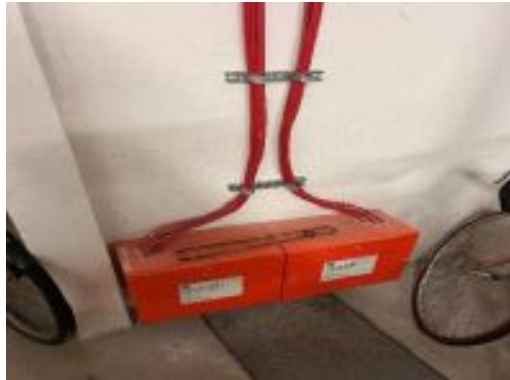
BMA - Bereichsverteiler – Kesselhaus/KG
