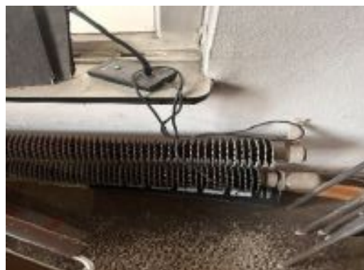
ELT Rippenrohr radiator –Pförtnerhaus/EG
