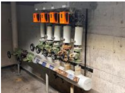
HZ-Verteil RLT – Lüftungszentrale/UG
