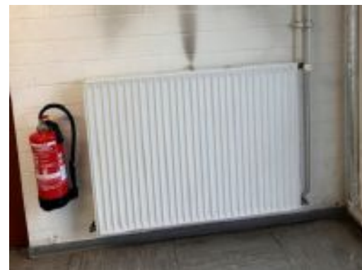
Planheizkörper – Flur Werkstatt/EG
