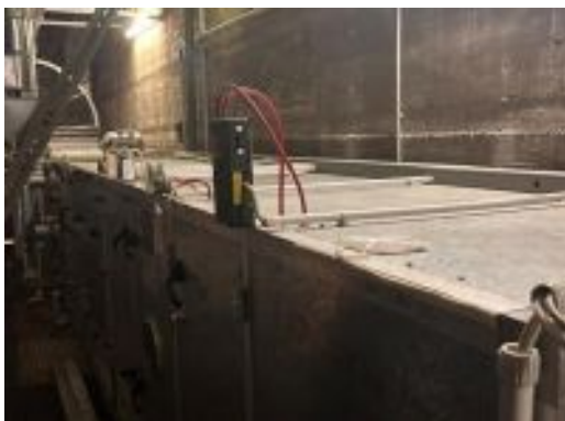
Zuluftgeräte Oberrang– Dachraum/DG
