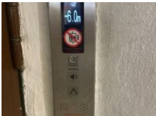
Bedientafel Lastenaufzug – EG
