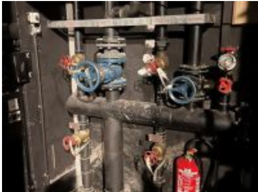
Sprühwasser-Löschanlage Bühne / EG
