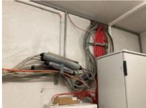
Verkabelung BMA – C-1.003
