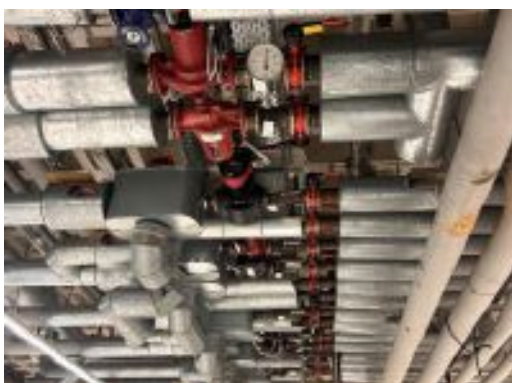
Pumpengruppe UKD– Technikzentrale/2.UG
