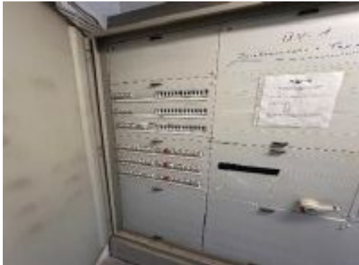
Unterverteilung UV1– Foyer/EG
